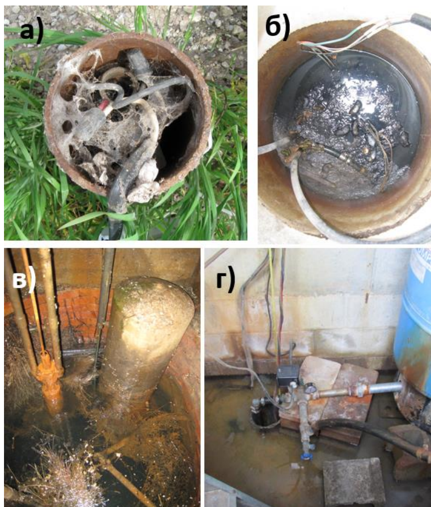
Рисунок 15 - Примеры антисанитарных условий на бытовых скважинах и колодцах; а) паутина внутри скважины, указывающая на активность насекомых; б) мертвые грызуны, плавающие в колодце; в) вырытый колодец с обильными корнями, торчащими из кирпичных стен; г) затопленный колодец и отсутствие крышки колодца, из-за чего поверхностная вода попадает в колодец (фотографии Stew Hamilton).
