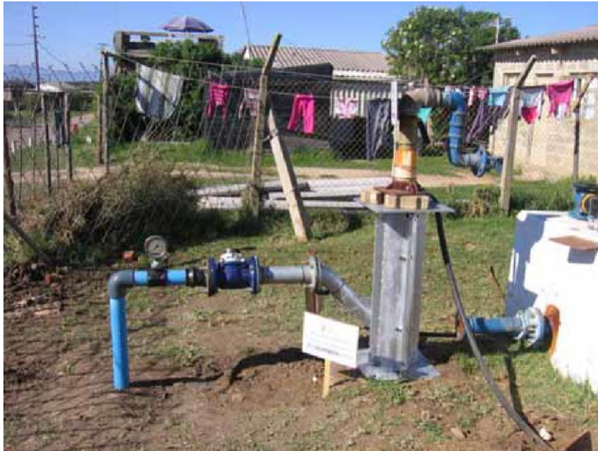
Figura 41 - Pozo de producción convertido para realizar una prueba de inyección (Murray y Ravenscroft, 2010).
