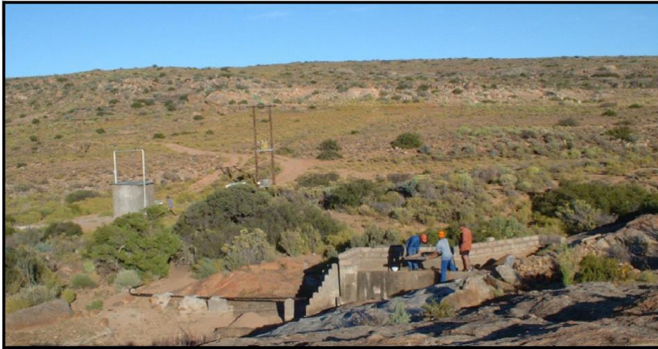
Figura 36 - Filtro de arena con pozo de inyección y extracción (casa de bombas) al fondo (Murray, 2008).
